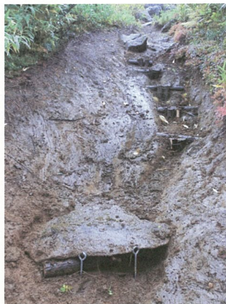
美瑛富士線 1400m 付近スリップ危険箇所階段工(その2) ⇒
