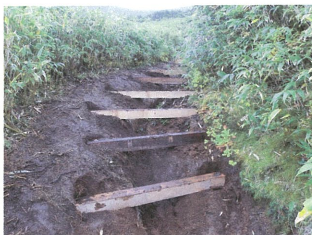
美瑛富士線 1400m 付近スリップ危険箇所階段工(その1)
