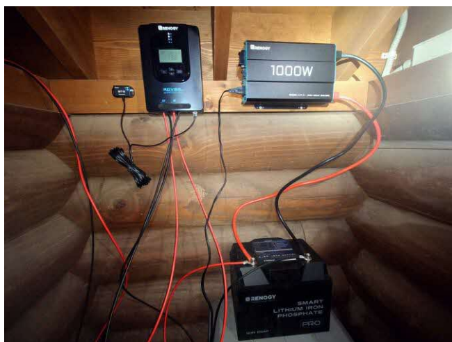
チャージコントローラー インバーター(100V1000W) バッテリー(12V100AH)
